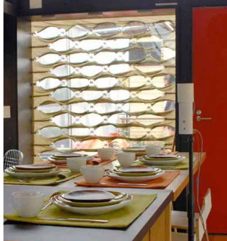
图 19. Self Regulating Shading System installed in east window of The University of Arizona Solar Decathlon Project. 安装在美国亚利桑那大学东边窗户上的太阳能十项全能项目中的自我调节遮阳系统。
